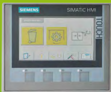
Quadro di controllo SIEMENS con sistema PROFINET
